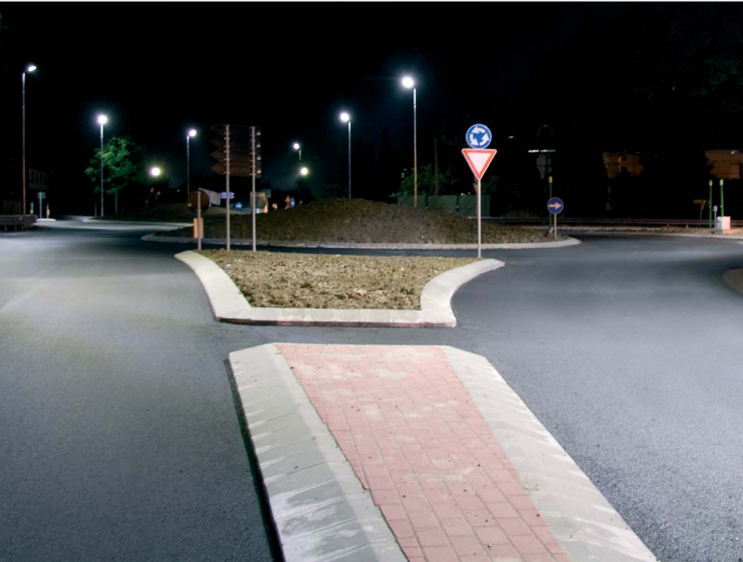
Lampade stradali a tecnologia LED
